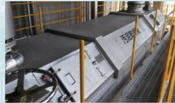
蒸気式間接加熱型乾燥機
