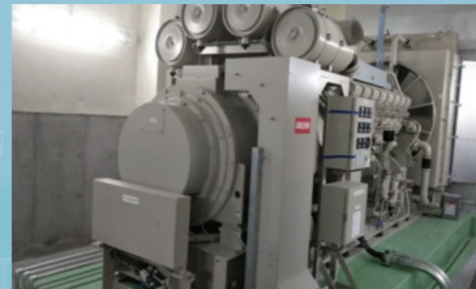
常用兼非常用発電機 (1,070kw)
