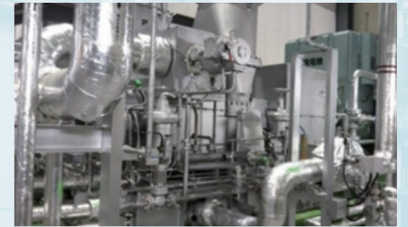
蒸気タービン
