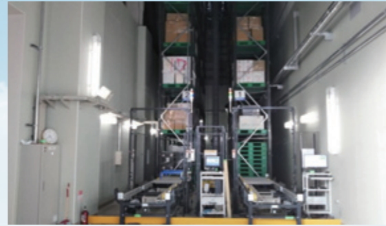
廃棄物自動倉庫
