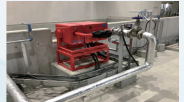
ピット火災監視装置・放水銃 (遠隔操作式)
