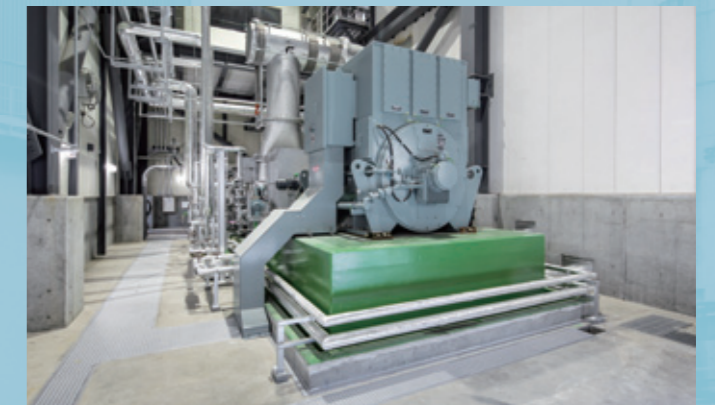
蒸気タービン発電機 (3,250kw)
