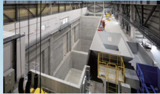
廃棄物ピット・クレーン
